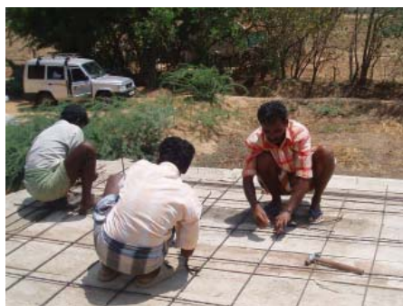
FILLER SLAB Les maçon apprennent à poser la structure de renforcement pour une toiture en Filler slab.
